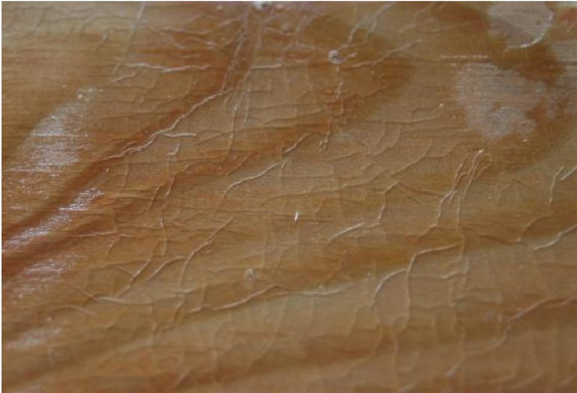
Zdjęcie 9. Niewłaściwie położona powłoka lakieru po wyschnięciu.
